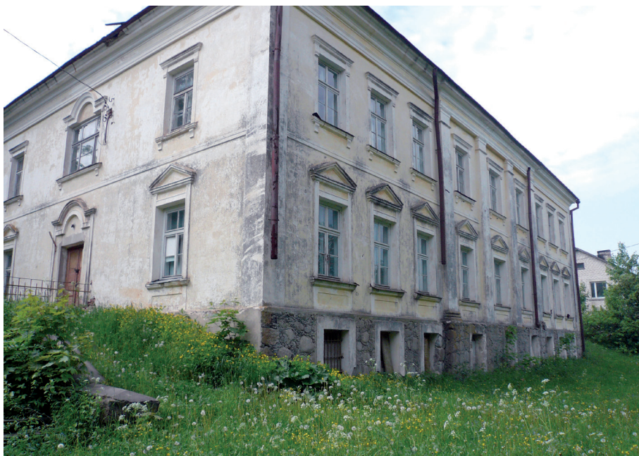
Il. 6. Obecnie dwór w Wielonach powoli ulega dewastacji, 2012 r. Fotografie przedstawiającą współczesny stan dworu w Wielonach przekazała mi dyrektor muzeum w Wielonach Margarita Skangale.
