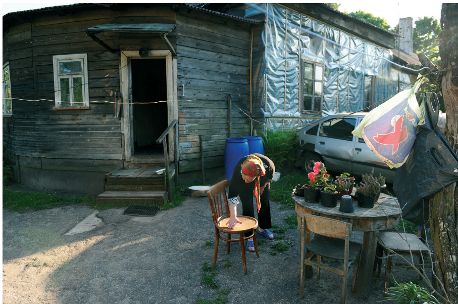
Il. 2. Dworek w Ustroniu od strony zabudowań gospodarczych. Obecnie jest zamieszkały, ale grozi mu całkowita ruina. Mieszkańcy ratują ściany, zabezpieczając je folią. Fot. Krzysztof Hejke, 2012 r.
