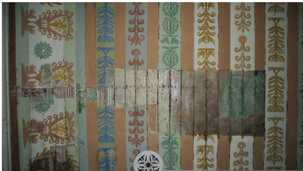
4. Turośl. Kościół pw. św. Jana Chrzciciela. Odkrywka na stropie nawy, 2015. Fot. M. Andron Turośl. Church of St. John the Baptist. Findings on the nave ceiling, 2015. Photo: M. Andron
