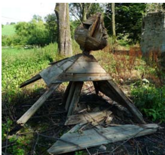
Płonna (gm. Bukowsko, pow. sanocki), cerkiew z 1823 (?) r. – resztki oryginalnej drewnianej konstrukcji zwieńczenia parawanowej, murowanej dzwonnicy /fot. autor 2009 r./
